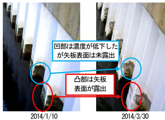
写真-5 矢板表面の植生の剥脱状況
