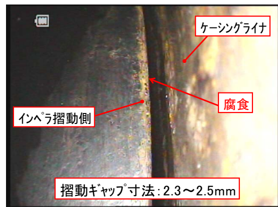
写真-4 インペラ摺動部の状況
