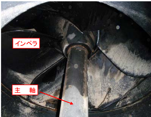
写真-5 インペラ, 主軸の状況(洗浄前)
