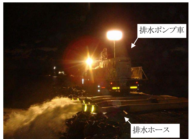
写真-9 照明装置の使用状況
