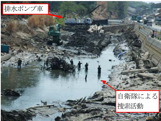
写真-5 低水位かつ異物を含む現場での排水状況
