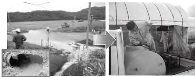
管路の漏水事故状況 (道路への土砂流出も発生)
