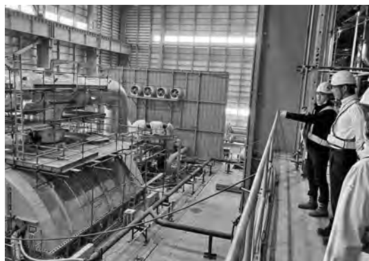
マタバリ石炭火力発電所
