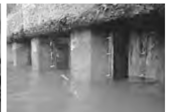
漁港施設の老朽化（鋼矢板の腐食）
