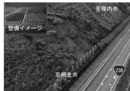
道路法面・盛土の土砂災害防止対策（国道238号 稚内市（対策前））
