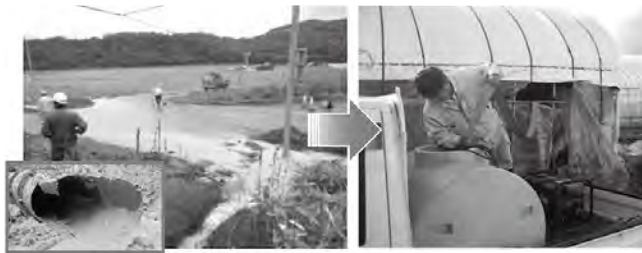
管路の漏水事故状況 (道路への土砂流出も発生)
