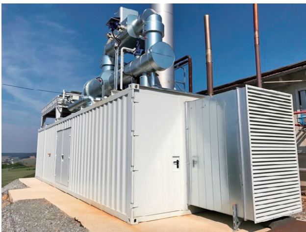
写真3 調整力提供用のバイオガスCHP (900kW: Jenbacher) (出典) 著者撮影
