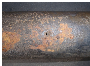
写真-1 漏水箇所 (空気弁立上鋼管)
